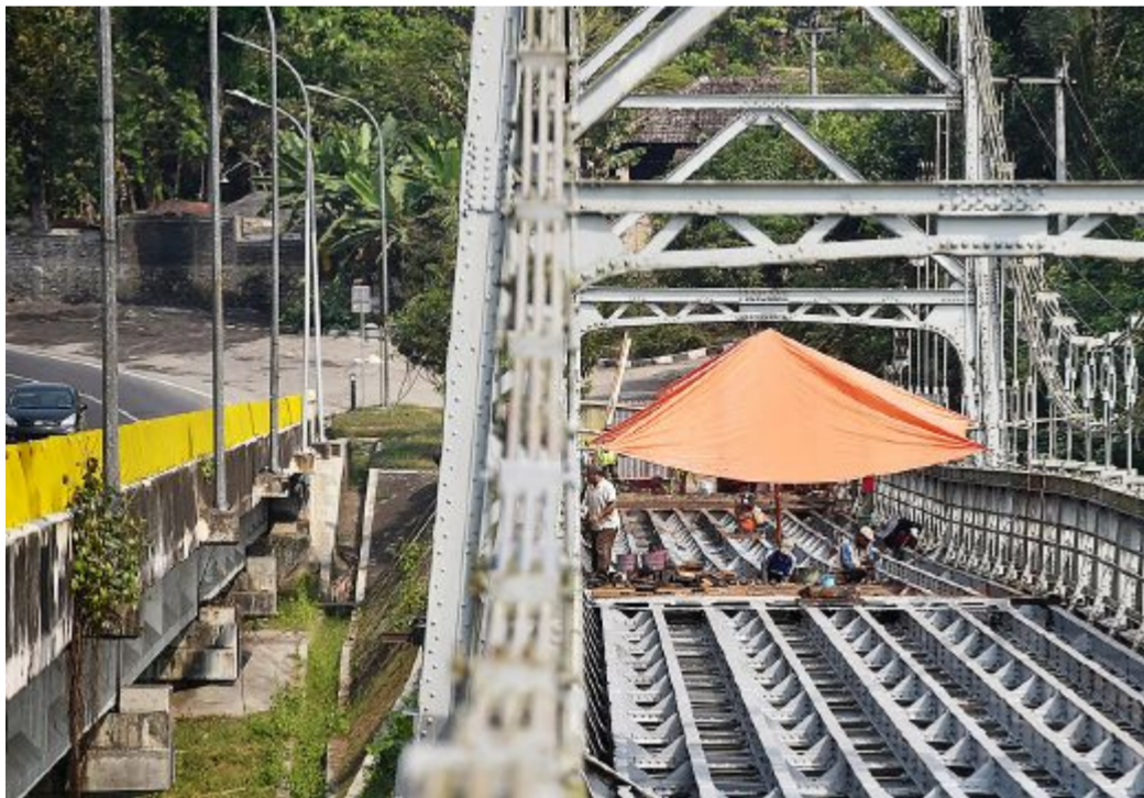
Pekerja memperbaiki kerangka Jembatan Bantar Lama di atas Sungai Progo, Kabupaten Kulon Progo, DI Yogyakarta, Sabtu (11/7). Perawatan berkala jembatan yang telah dikategorikan sebagai salah satu bangunan cagar budaya itu dikerjakan selama enam bulan dengan biaya Rp 3,7 miliar.
